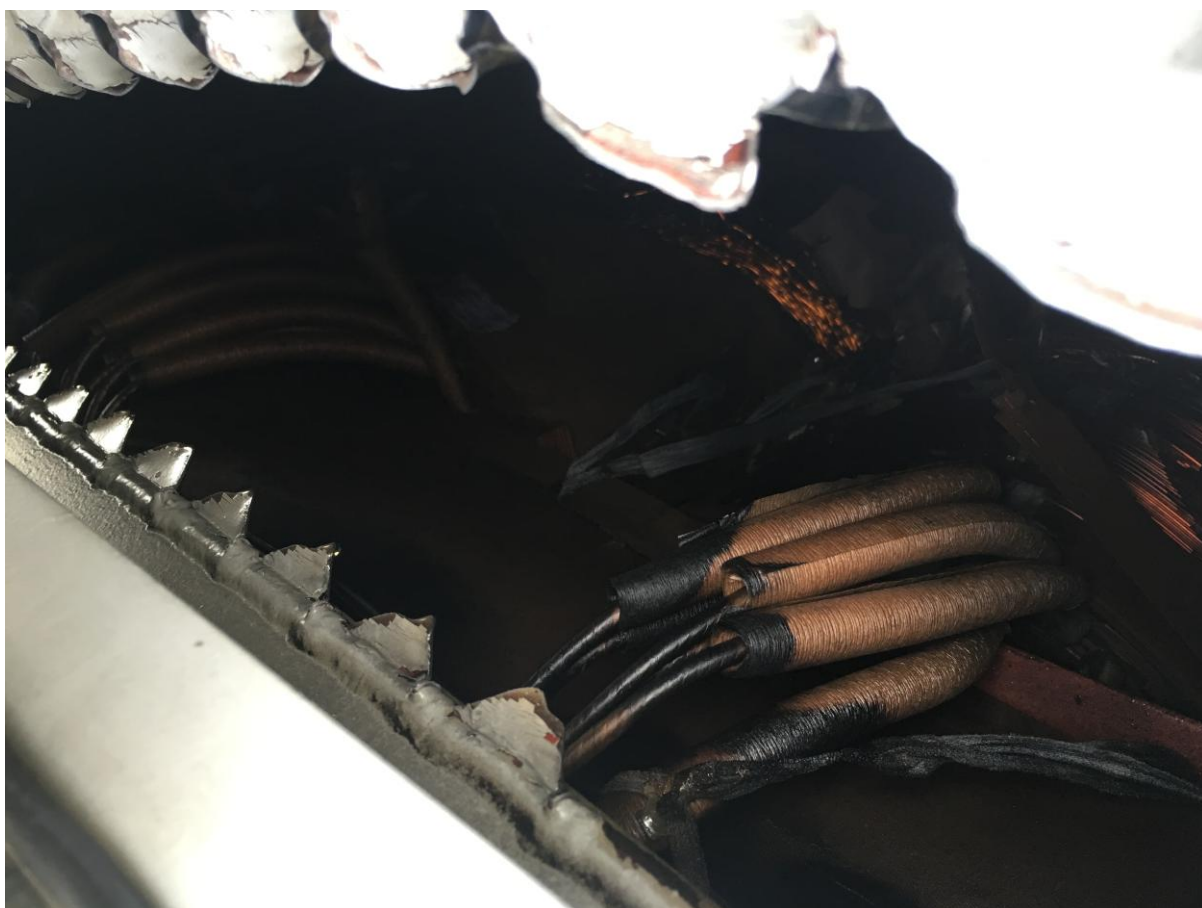
รูปที่ 6 Transformer ระเบิด
