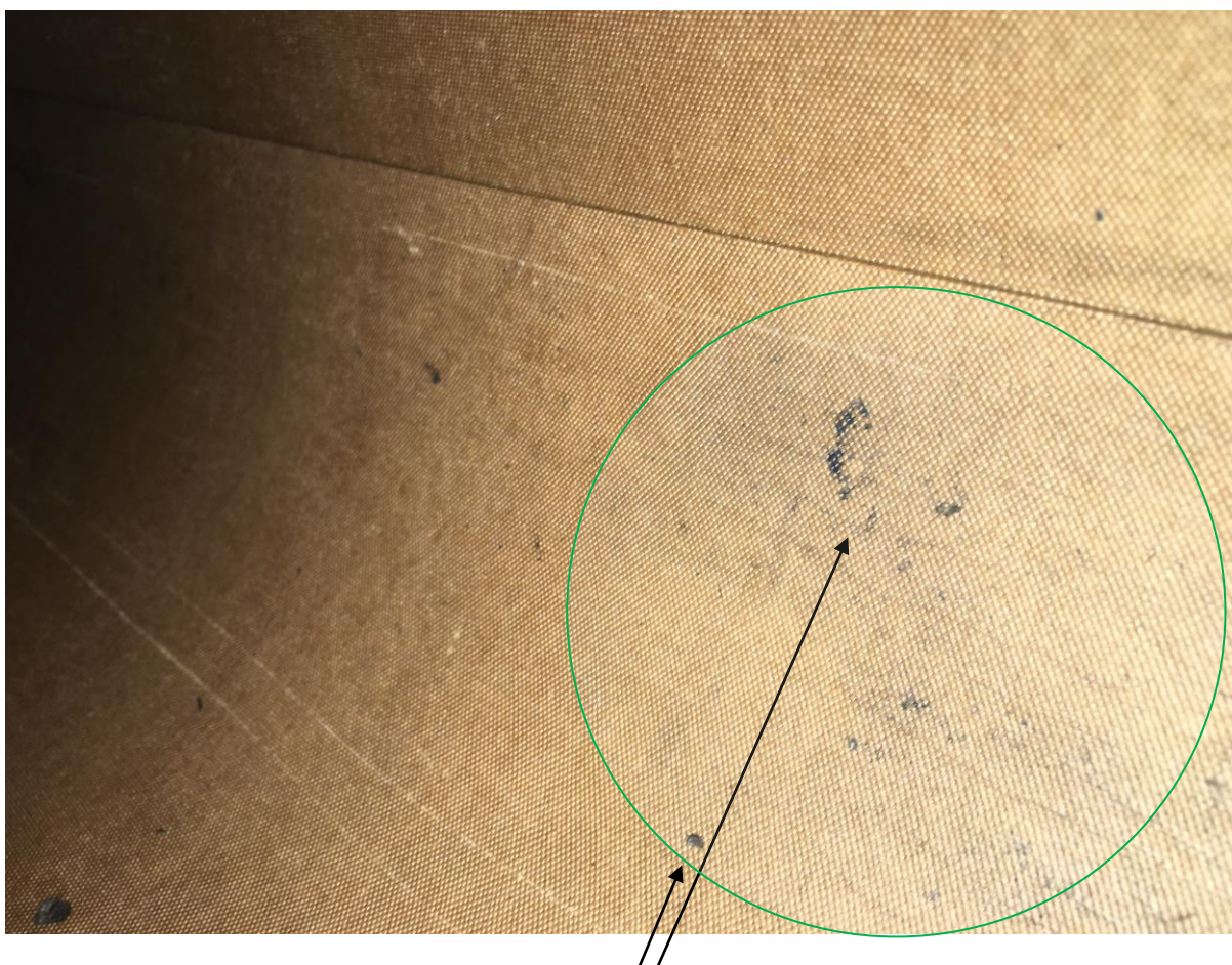
รูปที่ 5 พบรอยชำรุดของกระดาษรองขดลวดเนื่องจาก Partial discharge
