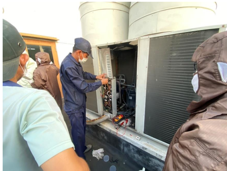
รูปที่ 2 Air condensing unit- magnetic contactor damage
