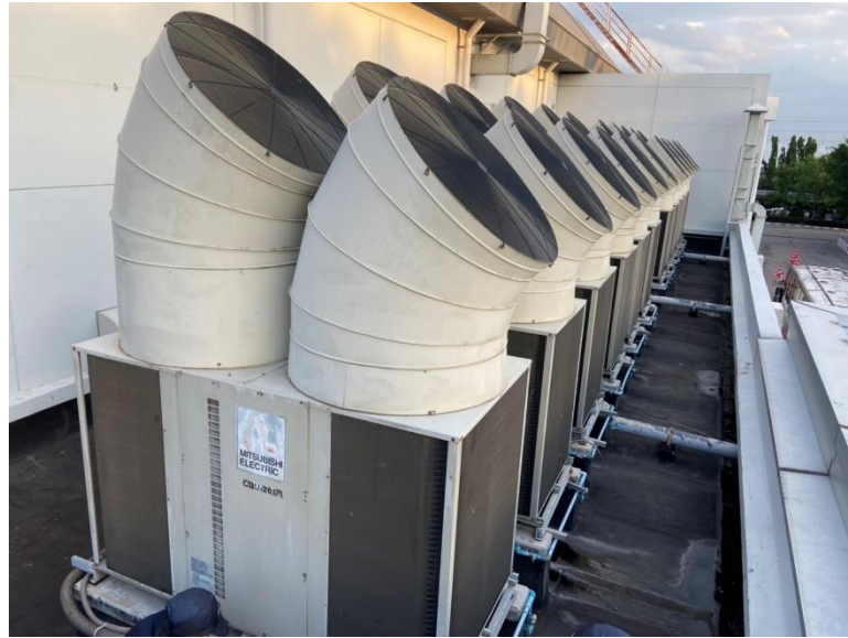
รูปที่ 3 Air condensing unit- magnetic contactor damage
