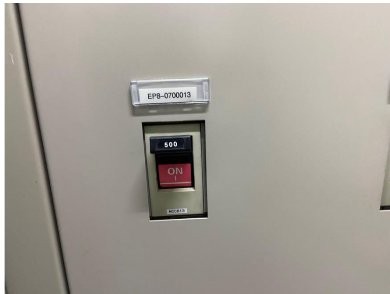
รูปที่ 4 MCCB for supply Air condensing 7 units
