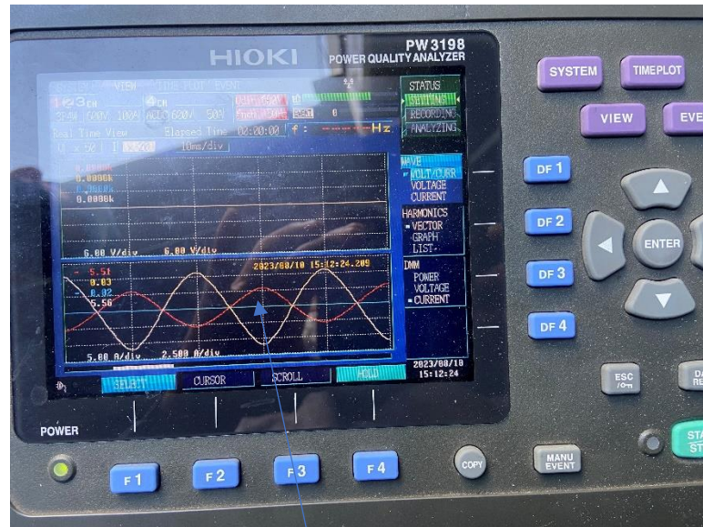
รูปที่ 1 Leakage current 3.5 Arms at neutral return cable
