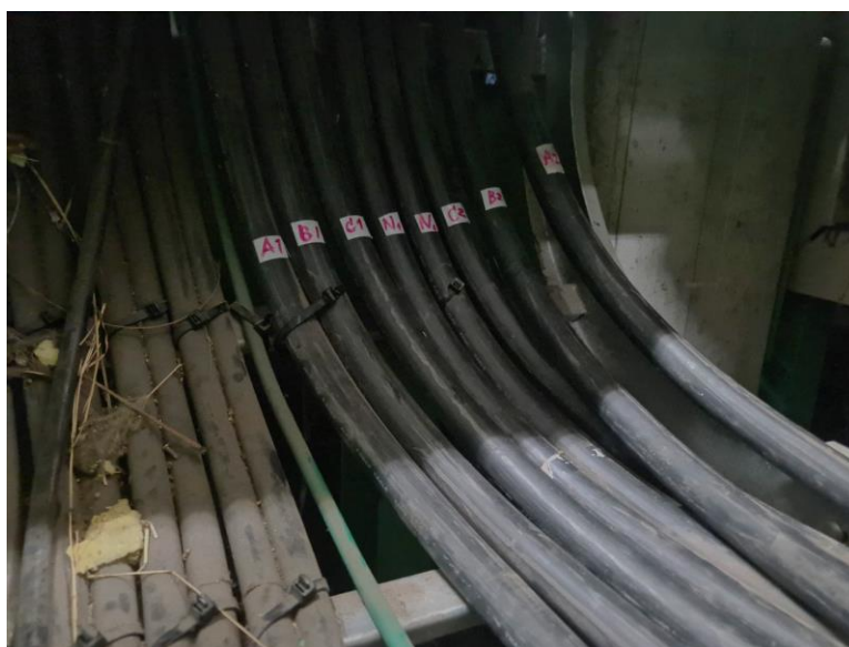
รูปที่ 17 : แสดงการติดตั้ง CABLE แต่ละเฟสใน CABLE LADDER
