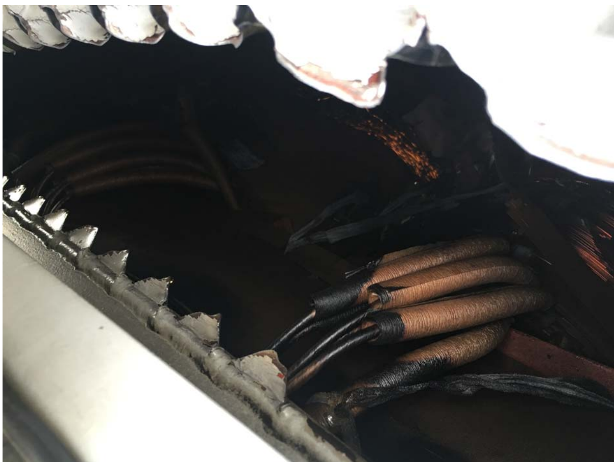
รูปที่ 6 Transformer ระเบิด
