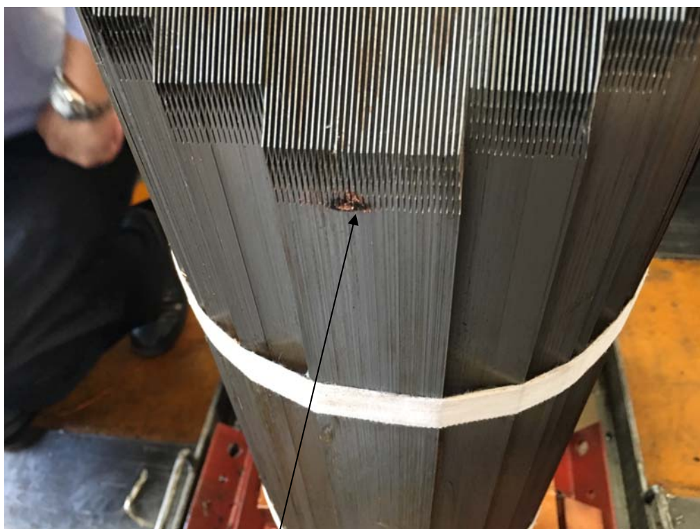
รูปที่ 4 พบมีรอย ชำรุดของแกนเหล็ก เพียงเล็กน้อย เนื่องจาก Partial discharge
