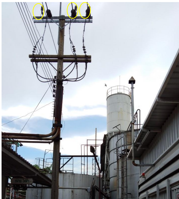
ภาพที่ 10 Lightning arrestor เริ่มเสื่อมสภาพ ได้ทำการปลดออกจากระบบไฟฟ้า
