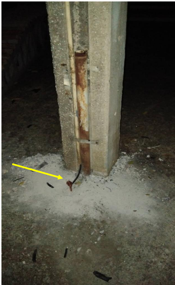
ภาพที่ 9 เสาไฟฟ้าไม่มีการต่อกราวด์ได้แก้ไขโดยการต่อกราวด์แล้ว
