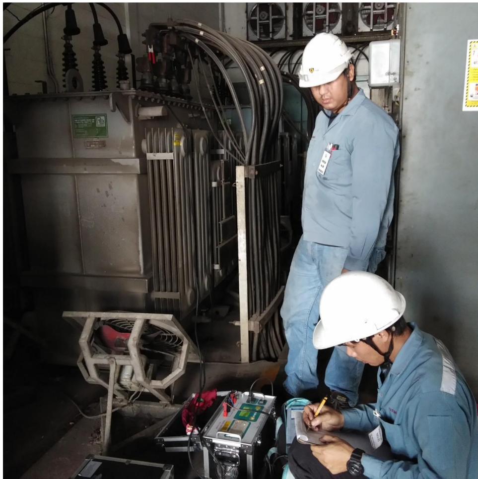
ภาพที่ 7 Winding resistance test ผลการทดสอบปกติ
