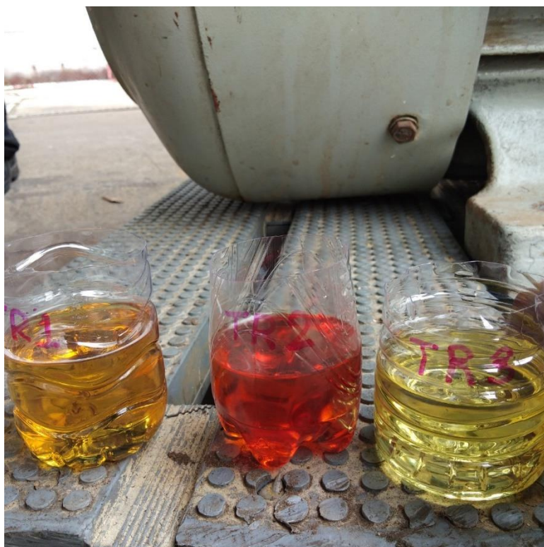
ภาพที่ 6 น้ำมันหม้อแปลงเริ่มเปลี่ยนสีได้เก็บน้ำมันส่งตรวจ Dissolved Gas Analysis (DGA)
