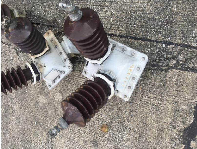
รูปที่ 18 PT ที่เสื่อมสภาพทำให้เกิด Fault
