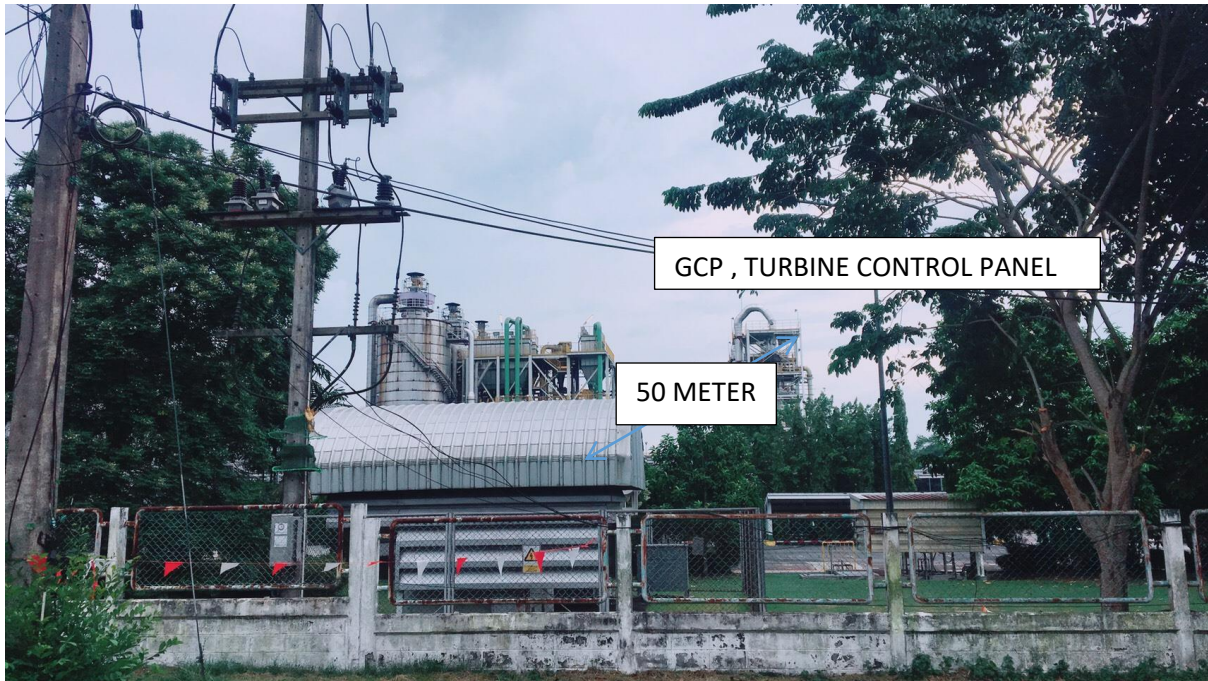
รูปที่ 14 ตำแหน่ง CT PT , 52B TO GCP , TURBINE CONTROL PANEL 50 METER
