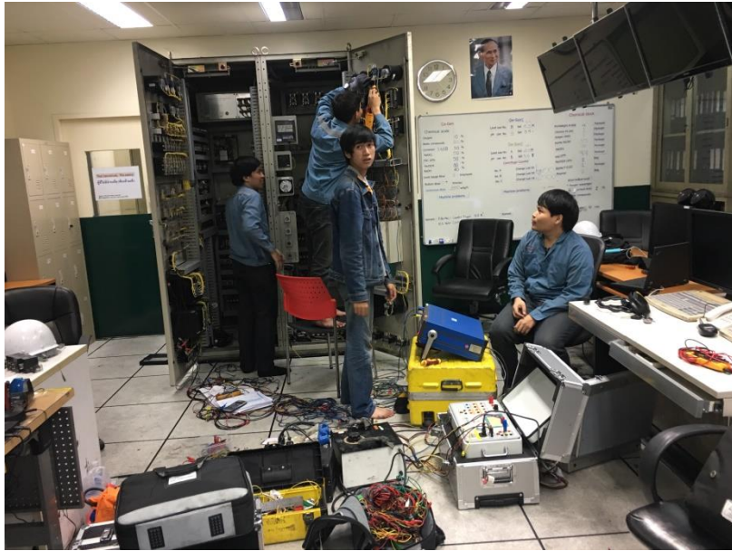
รูปที่ 12 ที่ GCP Panel - Test and Repair - Protective , metering and control device
