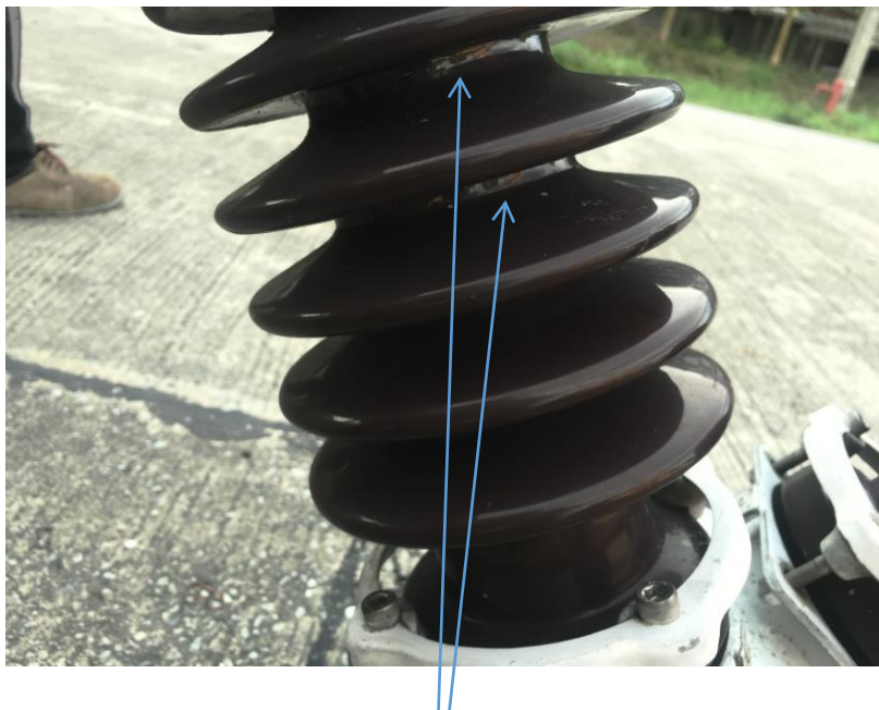
รูปที่ 19 PT ที่เสื่อมสภาพทำให้เกิด Fault
