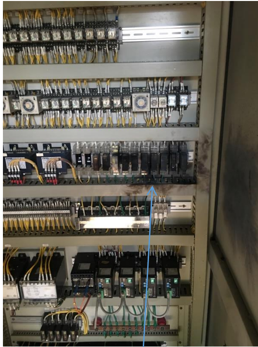
รูปที่ 5 ที่ 52 B - Flash over ที่ Surge protector device
