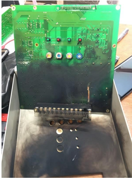
รูปที่ 7 ที่ GCP Panel - Flash over ที่ reactive power regulator
