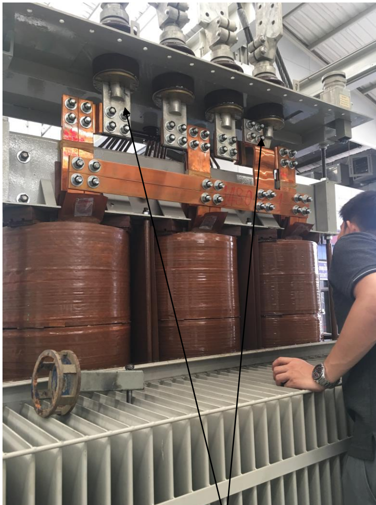
รูปที่ 4 Un tank transformer – พบ มี Defect จากการ Arc
