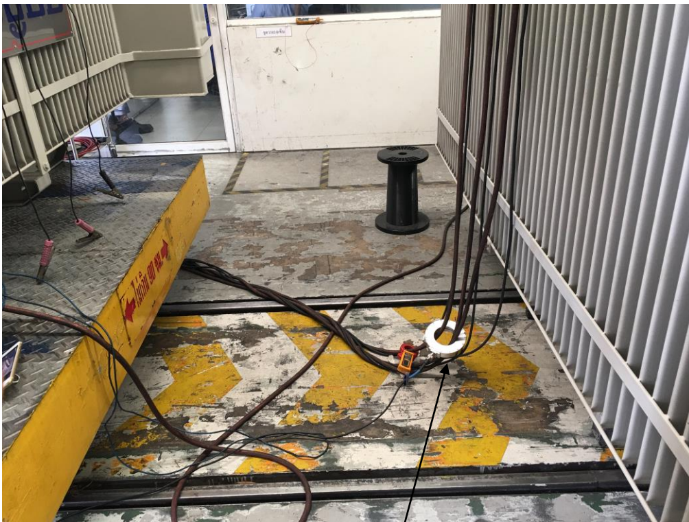
รูปที่ 2 ทำการวัด Arcing current ด้วย High frequency current transformer
