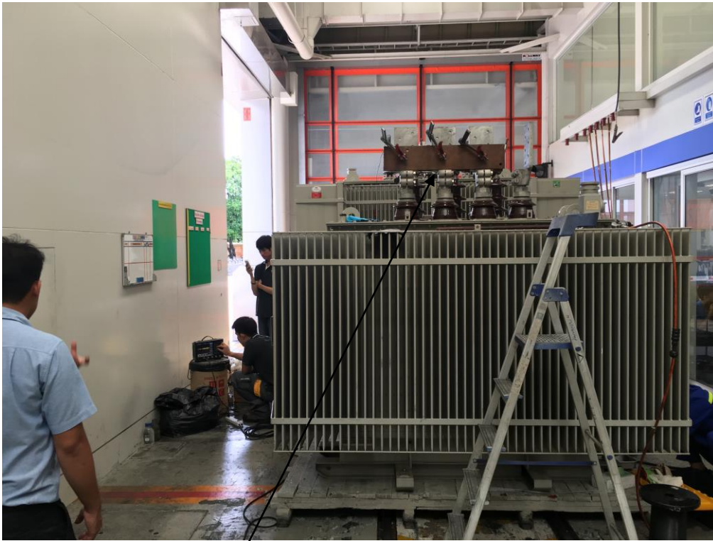
รูปที่ 1 ทำการ Short circuit test at 30 % rated current – วัด Arcing current
