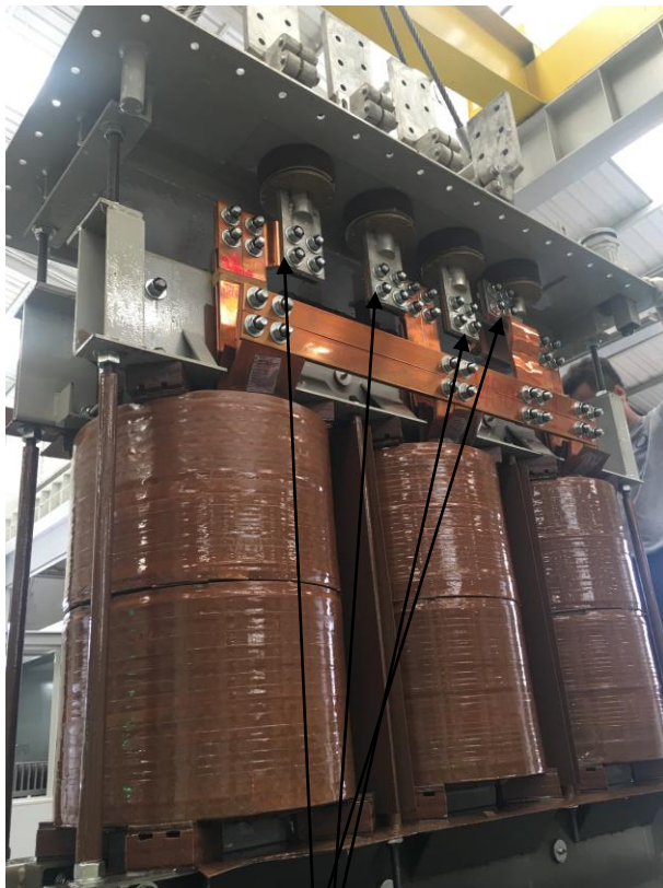
รูปที่ 10 ควรเชื่อม Flex bus bar ตรงจุดต่อที่ Transformer lug แทนการยึดด้วย nut
