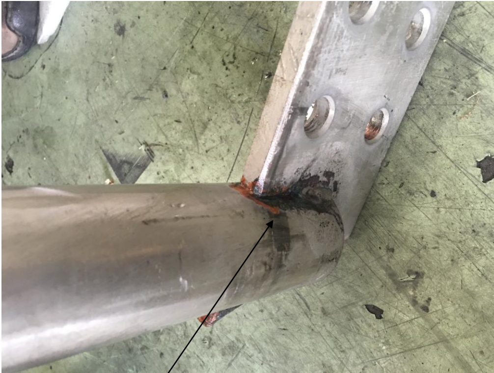
รูปที่ 5 Defect จากการ Arc
