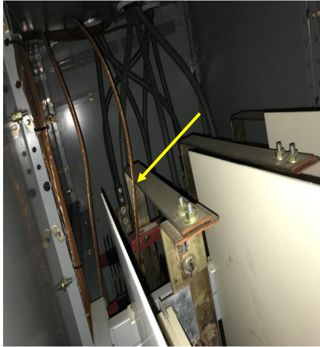
รูปที่ 8 : แสดงจุดที่สาย GROUND หลุดมาสัมผัสกับ BUSBAR ของ เฟส R
