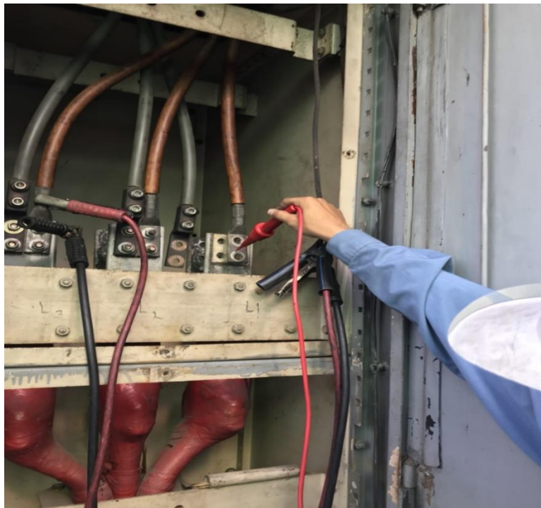
รูปที่ 7 : แสดงการวัดค่า INSULATION RESISTANCE POWER CABLE จาก TC1 PANEL ถึง SUBSTATION NO.5 เฟส R
