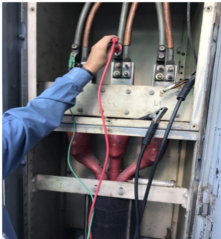
รูปที่ 4 : แสดงการทดสอบวัดค่า INSULATION RESISTANCE POWER CABLE เฟส Y
