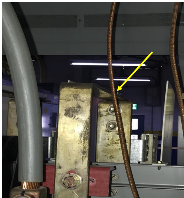
รูปที่ 9 : แสดงจุดที่สาย GROUND หลุดมาสัมผัสกับ BUSBAR ของ เฟส R
