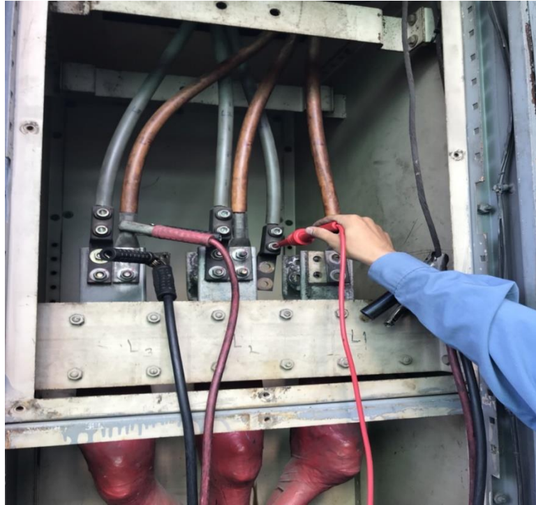
รูปที่ 6 : แสดงการวัดค่า INSULATION RESISTANCE POWER CABLE จาก TC1 PANEL ถึง SUBSTATION NO.1 เฟส R
